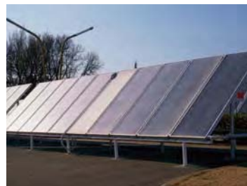
太陽電池モジュール
