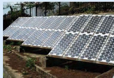
33年間屋外で使用された太陽電池のモジュール
