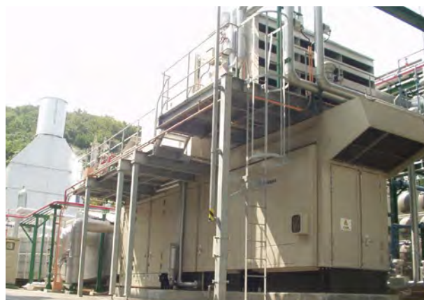
天然ガスを燃料としたコージェネレーションシステム
