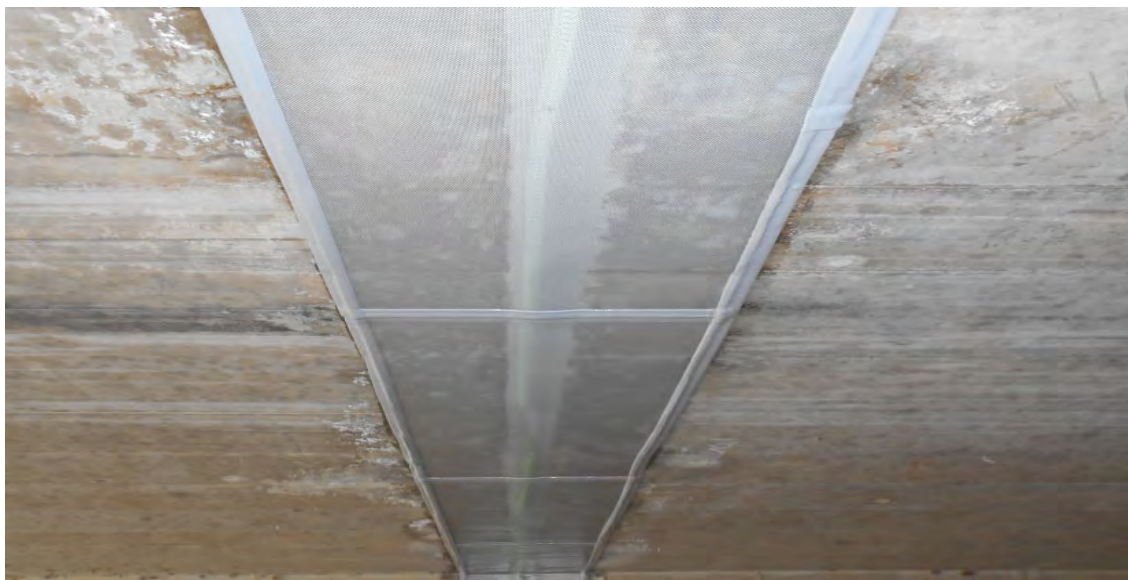
パッチシールクロスの表面から、内部のクラドリップと空間の土砂の堆積・滞水の状態が確認できます。
